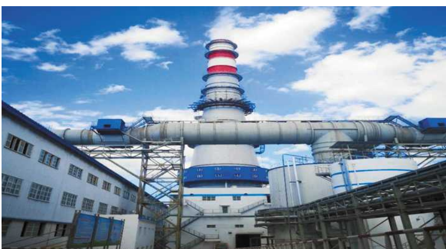
远达环保承建并运维我国首个铝业烟气污染物超零排放示范项目——内蒙古公司鸿鹭铝厂，其减排效果处于国际领先地位。图为该厂 1 号吸收塔。
